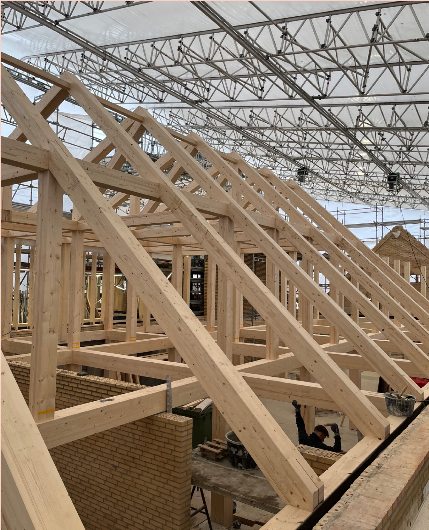
Tagkonstruktion fra Dyskærsgaard (december 2025). Foto: Liljeborg.
